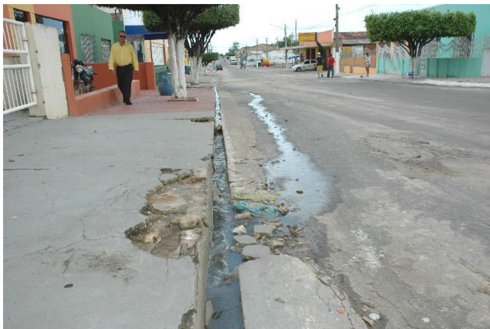
FOTO 04: Vista do esgoto na Avenida Josias Carvalho.
