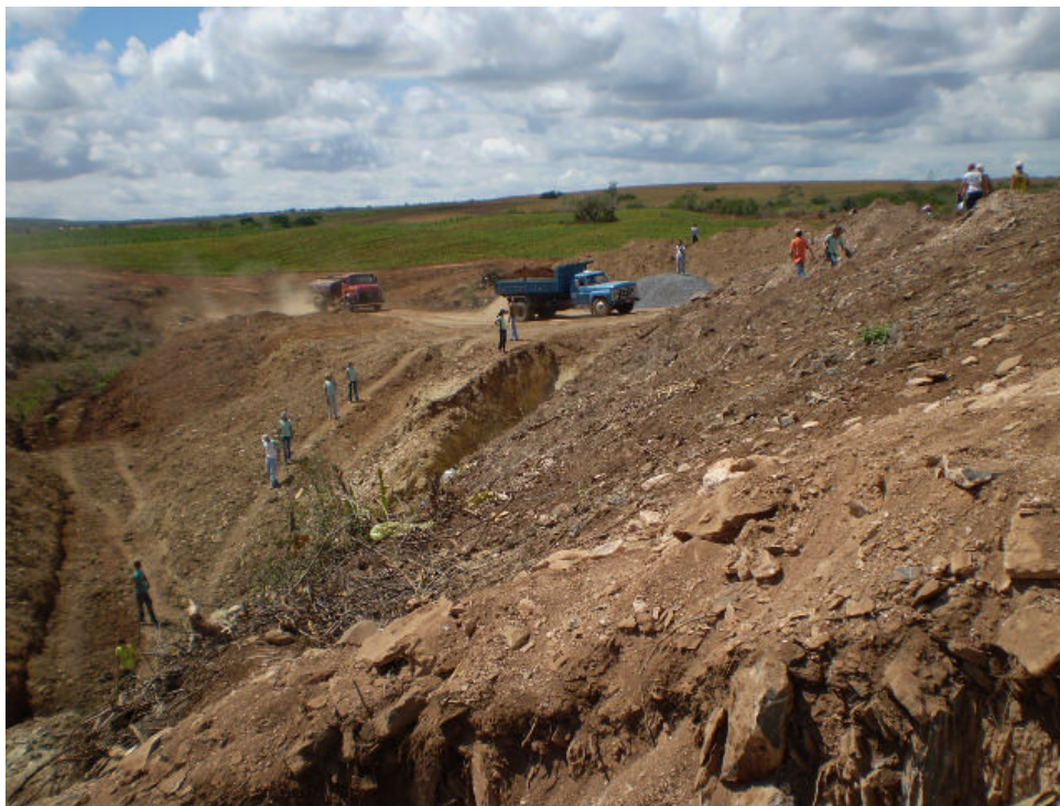
Figura 03. Visão lateral da barragem completamente devastada. São José – Poço Verde/SE
